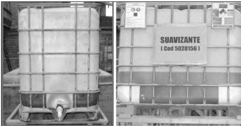
FIGURA 5. Codificación de tanques de químicos
