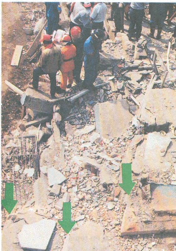
FOTO No. 6 Colapso total de un edificio de cinco pisos causados posiblemente por excesiva ductilidad de la estructura, obsérvese el desplazamiento relativo entre las losas. (Pereira 1995)
