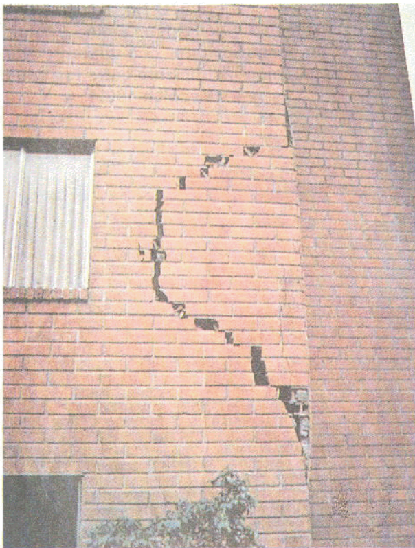
FOTO No. 3 Avería en los muros de fachada con posibilidad de desprendimientos por falta de refuerzo. (Medellín 1992)
