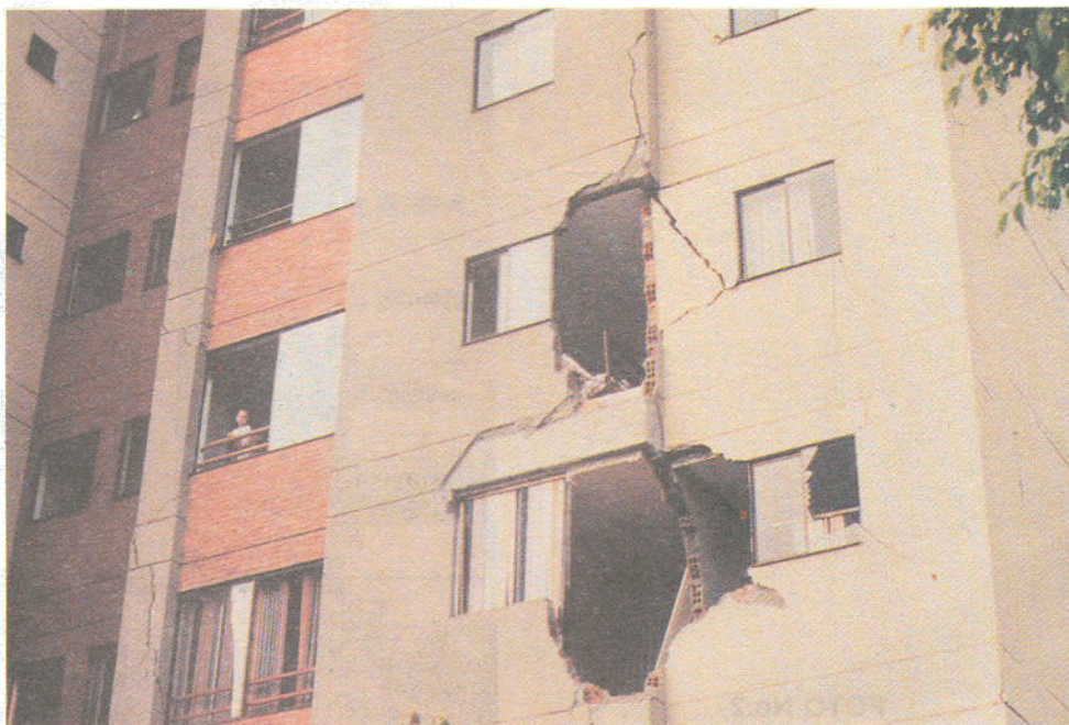
FOTO No. 4 Graves daños en la mampostería de fachada, no reforzada, con grave peligro por desprendimiento de ella. (Pereira 1995)
