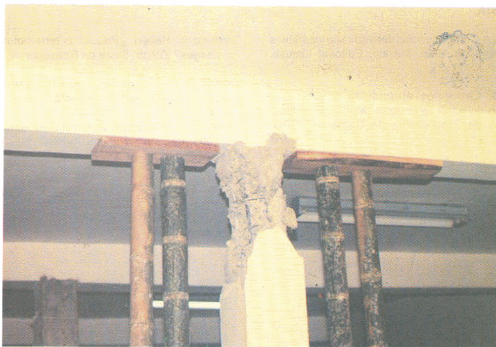
FOTO No. 9 Falla en columna por carga axial, sección insuficiente y mala calidad del hormigón. (Pereira 1995)
