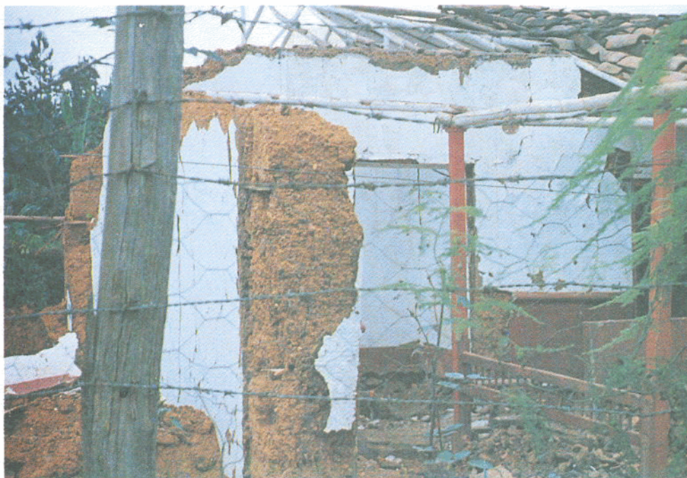
FOTO No. 8 Falla de vivienda rural con muros en tapia. (Urrao 1992)
