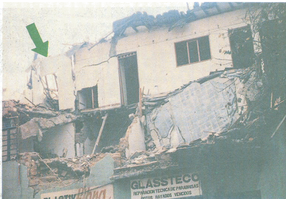
FOTO No. 7 Colapso de viviendas por falta de viga de amarre y confinamiento de muros. (Pereira 1995)
