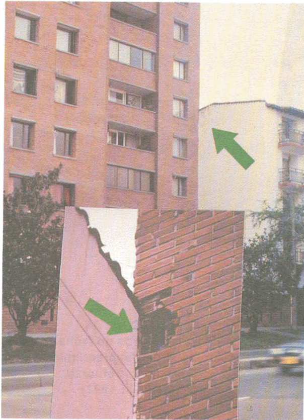
FOTO No. 1 Golpeteo y peligroso cambio de rigidez en construcciones con diferente altura, separación insuficiente entre los edificios. (Medellín 1992)
